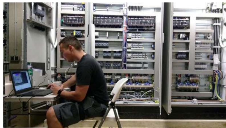
Ein Hallenbad besteht nicht nur aus Wasser, sondern auch aus jeder Menge Technik. Hier bereitet ein Programmierer die Steuerzentrale vor.
